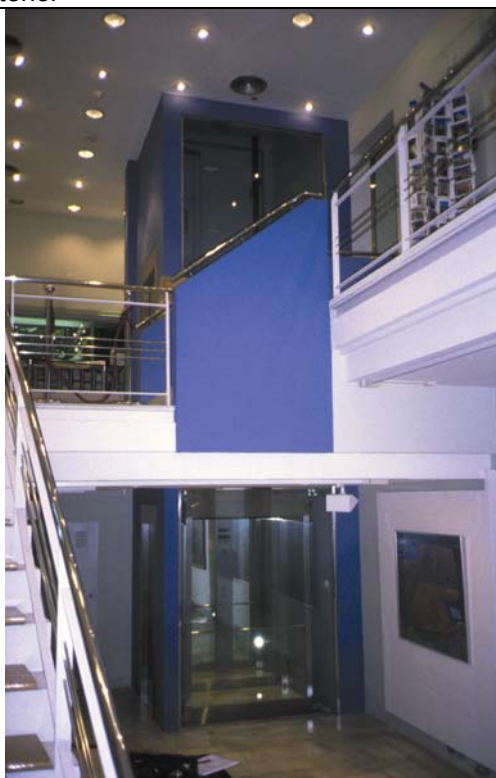
Foto2: Ascensor para comunicación vertical
